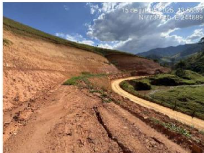
Figura 2 - Presença de fissuras superiores evidentes, indicando um processo de deslocamento e consequente perda de serviços executados.
